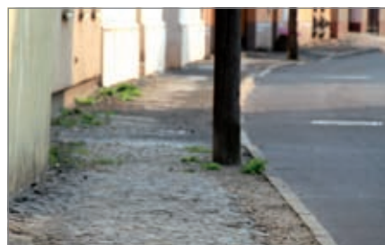
Der Gehweg an der Großen Straße: Geplant ist die Sanierung für 2019.
